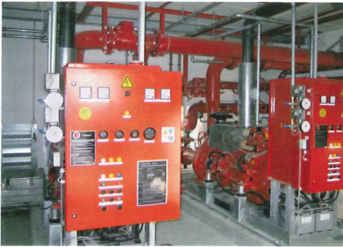
Löschwasserpumpen in der Sprinklerzentrale
